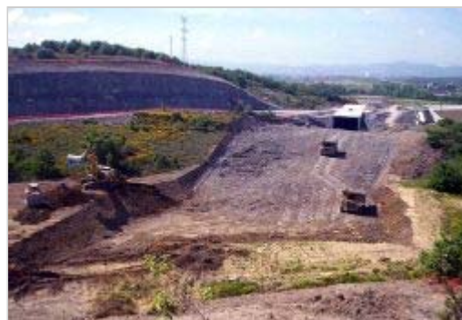
EN MARCHA. Trabajos para desplegar el TAV en el tramo de Arrazua, en Legutiano. / EL CORREO
